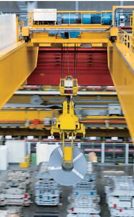
コイル搬送 MPW ウインチ付き天井クレーン
